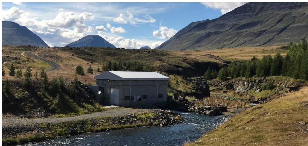
Mynd 4. Stöðvarhús Djúpadalsvirkjunar I.
